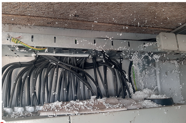
2. Gryzonie często uszkadzają warstwy ocieplenia budynków oraz instalacji elektrycznych nawet w nowo powstałych obiektach
