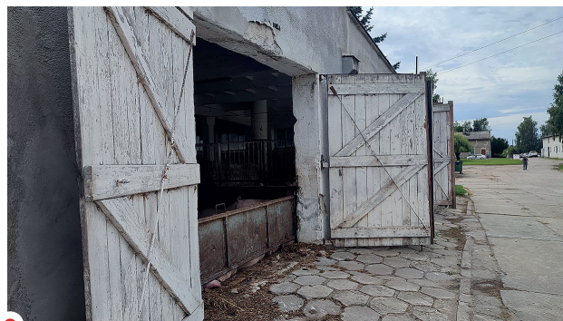
Fot. 1. Budynek niezabezpieczony przed dostępem zwierząt wolno żyjących i domowych
